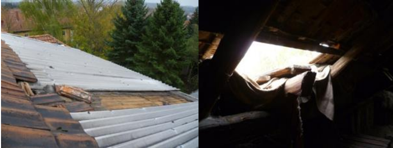
Schaden am Dach
